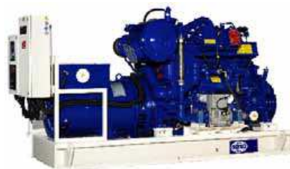
Agregat do Kogeneracji
